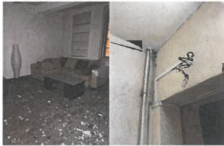
↑ -Vétusté des raccordements électriques dans les locaux communs
